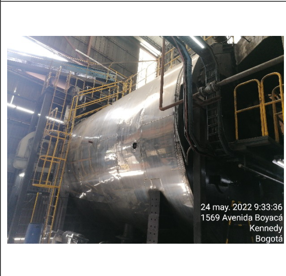
FOTOGRAFÍA No. 3. Caldera JCT de 1200 BHP
